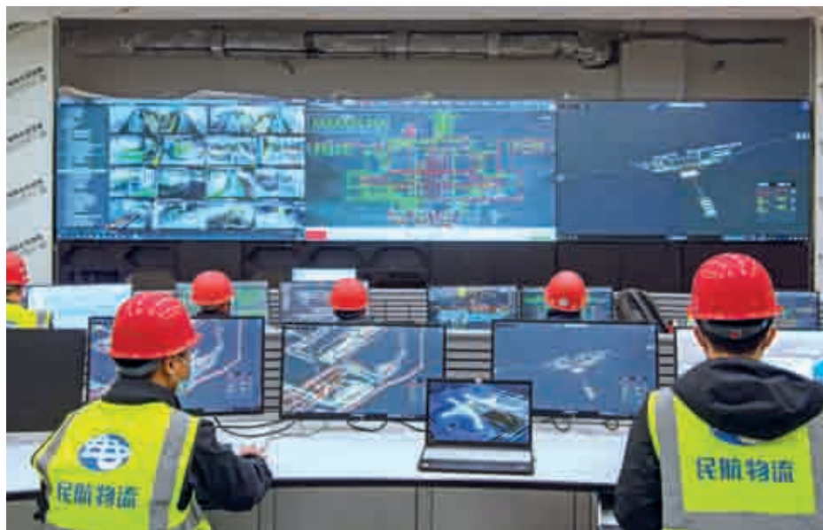
候机楼一楼现场控制机房，技术人员监控整个候机楼行李运行状态。
